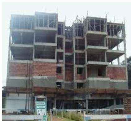
Figura 3 – Edifício Camila, em Goiânia, primeira grande obra com uso de CAA no Brasil. Fonte: Geyer (2005)
