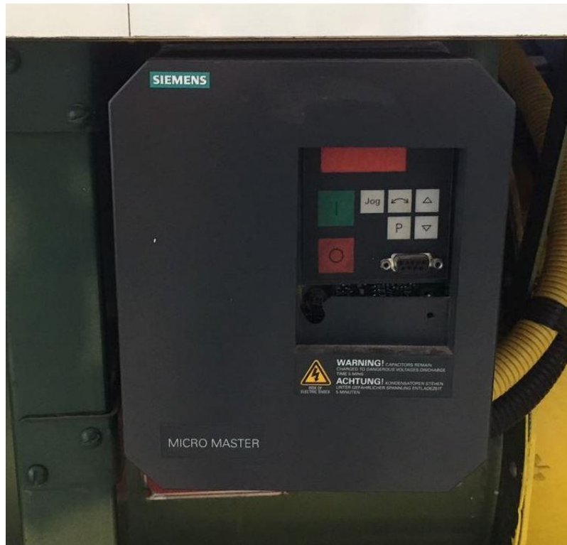
Figura 11 - Inversor de frequência do túnel de vento usado
