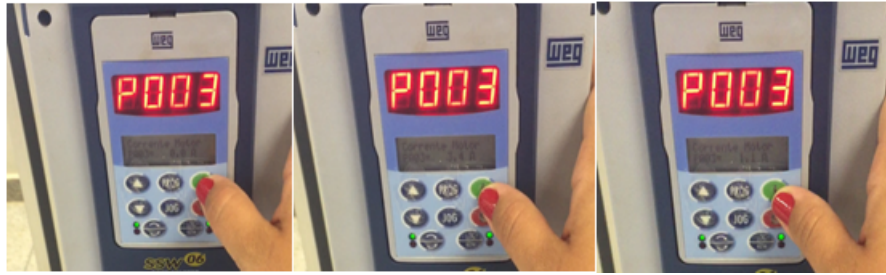
Figura 53 – Medição da corrente com o equipamento elétrico Soft-Starter , tempo de 1 a 5 segundos. É um tipo de partida que não ocasiona tranco em motores, devido à inserção de potência ocorrer aos poucos, ou seja, suavizando a partida.
