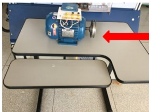
Figura 10 – A ilustração mostra o motor solto sobre a bancada. Quando ligado, provoca ruído e vibração, podendo ocasionar deslizamento, ou seja, um risco físico de grau pequeno que, no entanto, sem monitoramento, pode até ocasionar a queda do motor. Fonte: A autora
