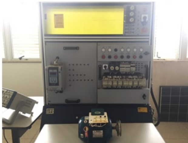
Figura 8 – Bancada didática no Laboratório de Eletricidade para a execução dos experimentos, compreendendo as seguintes placas: P001 (energização da bancada), P025 ( Soft-Starter para realização dos experimentos), P012 ( Fusíveis- proteção de sobrecarga), motor trifásico (para realização dos acionamentos sugeridos pelo usuário) e P007 (Quadro de comandos + sim. defeitos). Concomitantemente há riscos de acidente, tais como, queda do motor devido a estar solto em cima de uma mesa frágil; e choque elétrico, na bancada. Fonte: A autora
