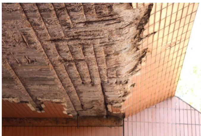
Figura 4.6 – Elemento tabuleiro com corrosão de armaduras e abrasão do concreto
