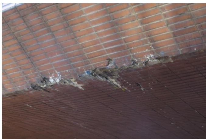
Figura 4.2 – Elemento tabuleiro com danos no revestimento
