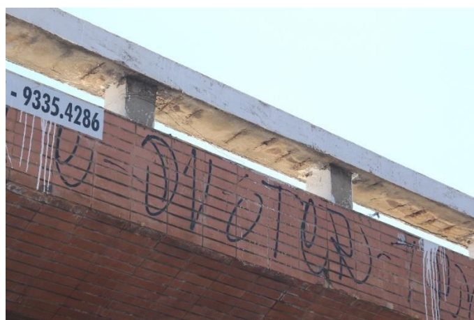
Figura 4.18 – Elemento guarda-rodas L com corrosão de armaduras, eflorescência, deslocamento, infiltração de água e manchas
