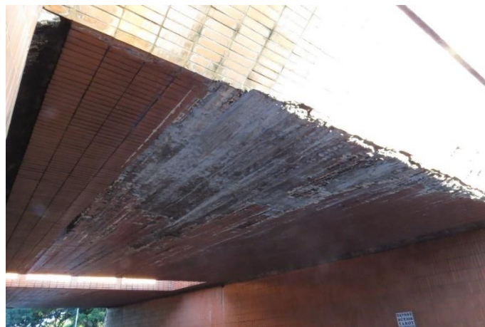
Figura 4.3 – Elemento tabuleiro com manchas e abrasão do concreto
