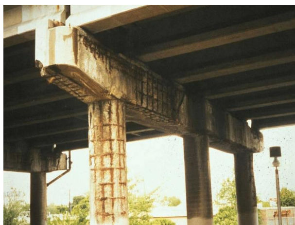
Figura 2.1 – Exemplo de corrosão de armaduras em OAE (Fonte: https://www.researchgate.net )
