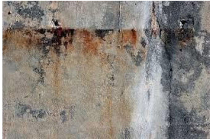
Figura 2.5 – Exemplo de manchas na superfície de concreto (Fonte: https://www.atex.com.br )
