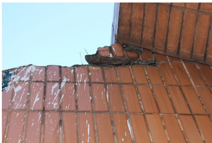
Figura 4.5 – Elemento cortina norte W com corrosão de armaduras e perda de seção
