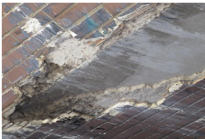
Figura 4.19 – Elemento tabuleiro com manchas e abrasão do concreto
