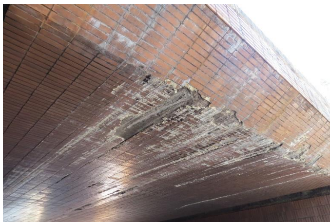
Figura 4.22 – Elemento tabuleiro com corrosão do concreto
