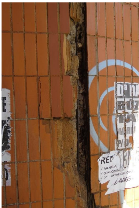
Figura 4.12 – Elemento cortina central sul com corrosão de armaduras e deslocamento
