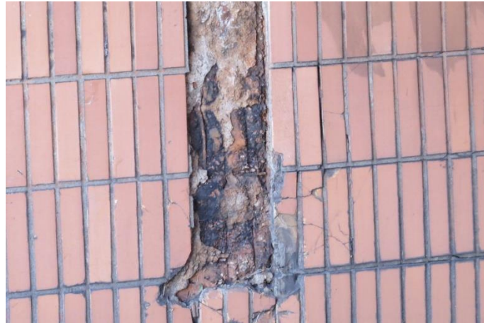
Figura 4.7 – Elemento cortina central norte com corrosão de armaduras, manchas e abrasão do concreto
