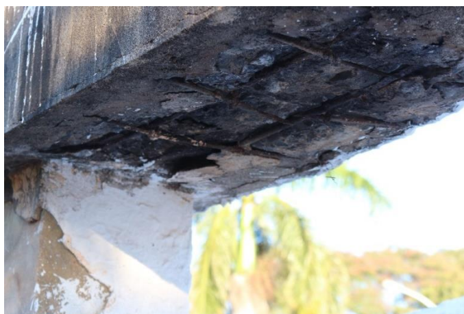
Figura 4.4 – Elemento guarda-rodas L com corrosão de armaduras e fissuras
