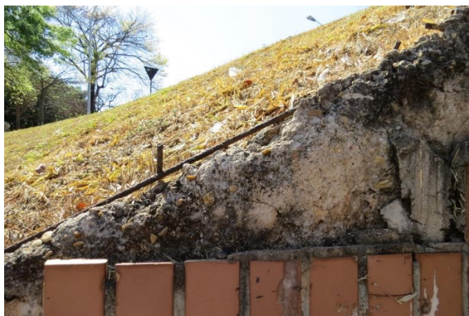
Figura 4.10 – Elemento cortina norte W com corrosão de armaduras, manchas e abrasão do concreto
