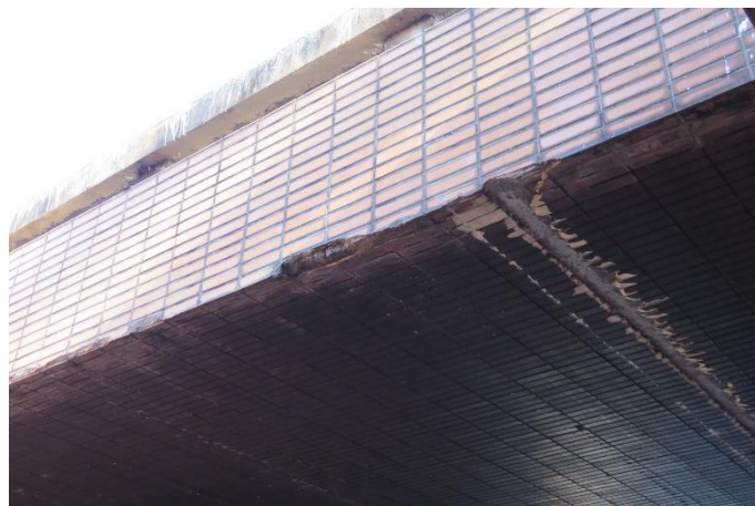
Figura 4.13 – Elemento tabuleiro com manchas e abrasão do concreto
