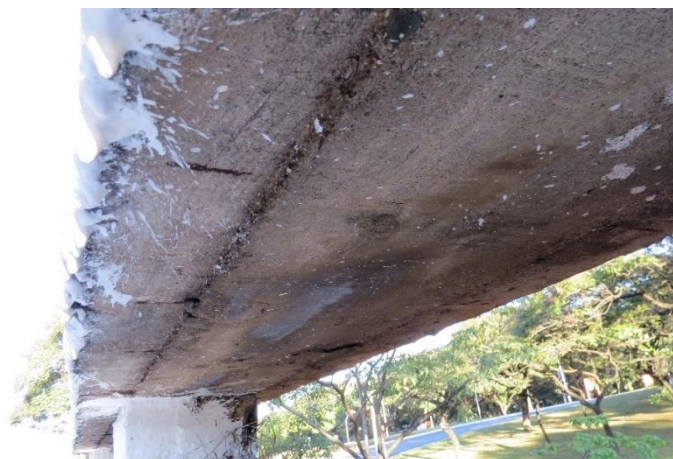
Figura 4.14 – Elemento guarda-rodas L com eflorescência e infiltração de água
