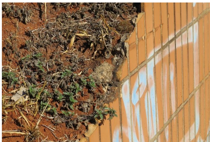
Figura 4.20 – Elemento cortina sul L com abrasão do concreto e manchas
