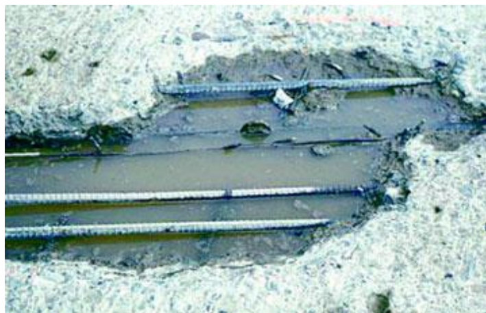
Figura 2.6 – Exemplo de abrasão do concreto por ação da água (Fonte: http://builtconstructions.in )
