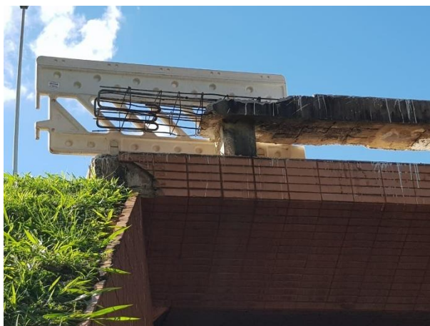
Figura 4.1 – Elemento guarda-rodas L com estrutura parcialmente colapsada
