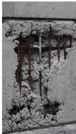
Figura 2.2 – Exemplo de desagregação do concreto (Fonte: http://www.colegiodearquitetos.com.br )
