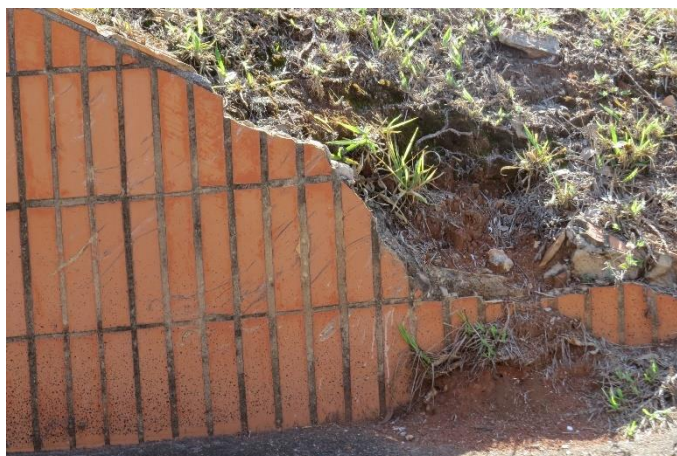
Figura 4.23 – Elemento cortina norte L com abrasão do concreto
