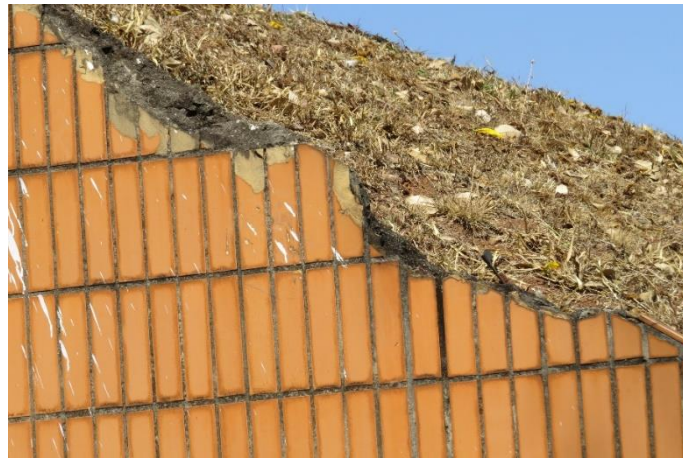
Figura 4.11 – Elemento cortina sul W com corrosão de armaduras, manchas e abrasão do concreto
