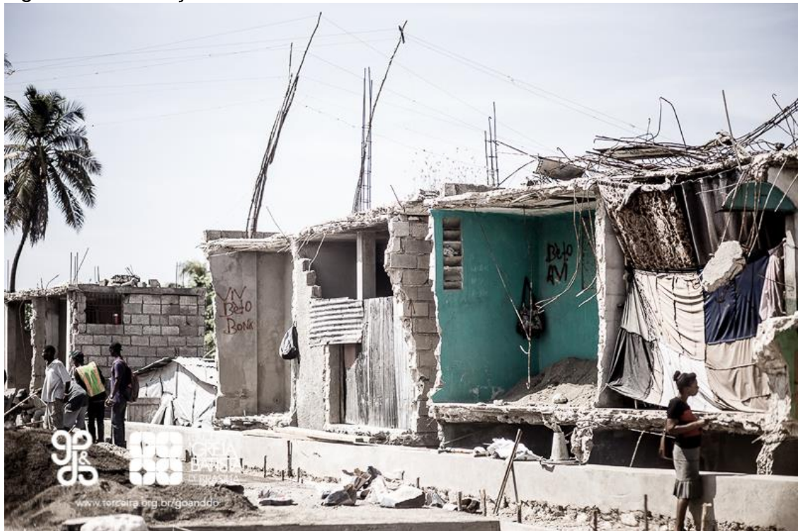
Figura 1 - Destruição do Terremoto de 2010
