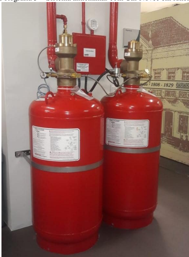
Fotografia 5 - Sistema antichamas com Gás Novec em funcionamento no STF.
