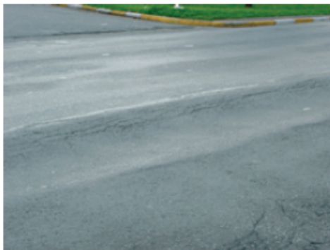
(a) Afundamento plástico nas trilhas de roda
