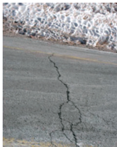
(b) Trinca de retração térmica
