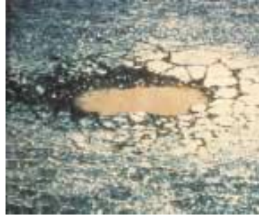
Figura A.15 - Painelas de alta severidade (SHRP, 2003)
