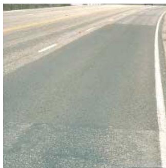
Figura A.10 - Remendos de baixa severidade (SHRP, 2003)
