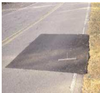
Figura A.11 - Remendos de baixa severidade (SHRP, 2003)
