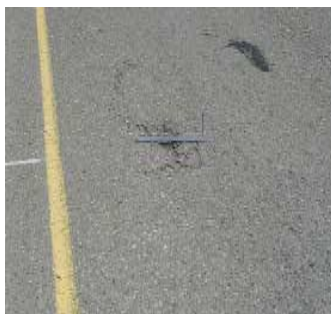
Figura A.13 - Painelas de baixa severidade (SHRP, 2003)
