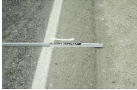
Figura A.21 – desnível pista-acostamento (SHRP, 2003)
