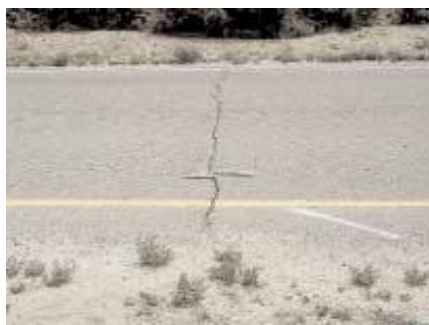
Figura A.9 – Trincas transversais de alta severidade (SHRP, 2003)
