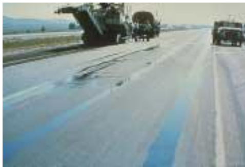
Figura A.16 - afundamentos de trilhos de roda demarcados pelo acúmulo de água (SHRP,2003)
