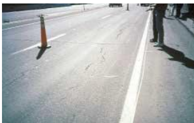
Figura A.1 – Trincas por fadiga do revestimento severidade baixa (SHRP,2003)
