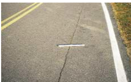
Figura A.6 – Trincas longitudinais de moderada severidade (SHRP, 2003).
