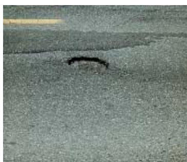
Figura A.14 - Painelas de média severidade (SHRP, 2003)
