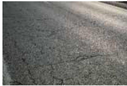
Figura A.4 – Trincas em blocos alta severidade (SHRP, 2003)
