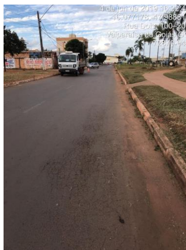
Figura 3.4 – Segmento com presença de trincas
