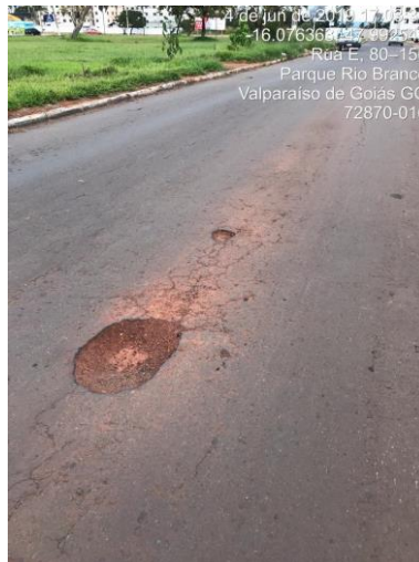
Figura 3.4 – Segmento com identificação de painelas e trincas
