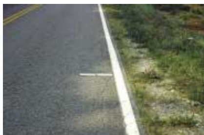
Figura A.5 – Trincas nos bordos baixa severidade (SHRP, 2003)
