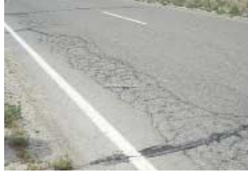
Figura A.3 – Trincas por fadiga do revestimento severidade alta (SHRP,2003)
