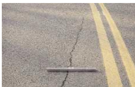
Figura A.7 – Trincas longitudinais de alta severidade (SHRP, 2003).
