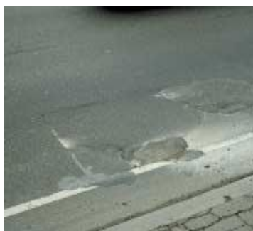
Figura A.12 - Remendos de baixa severidade (SHRP, 2003)
