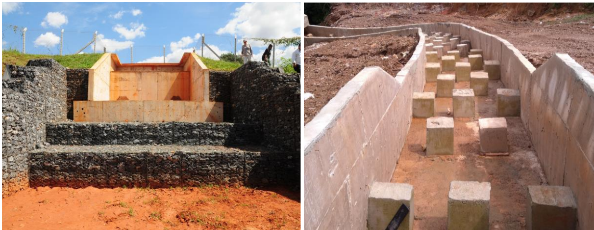
Figura 3.5. Exemplos de dissipadores de energia hidráulica, onde a foto da esquerda representa uma escada hidráulica.
