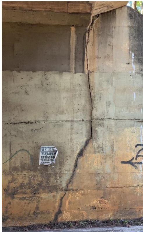
Figura 4.5: Exemplo de fissura – 05/06 Norte, Brasília – DF
