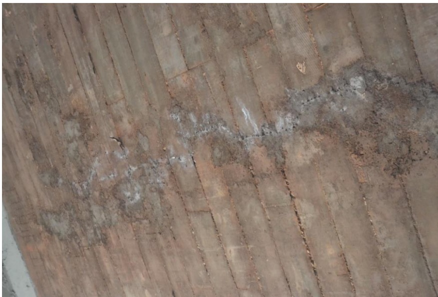
Figura 37: Exemplo A - eflorescência com fator de intensidade 2
