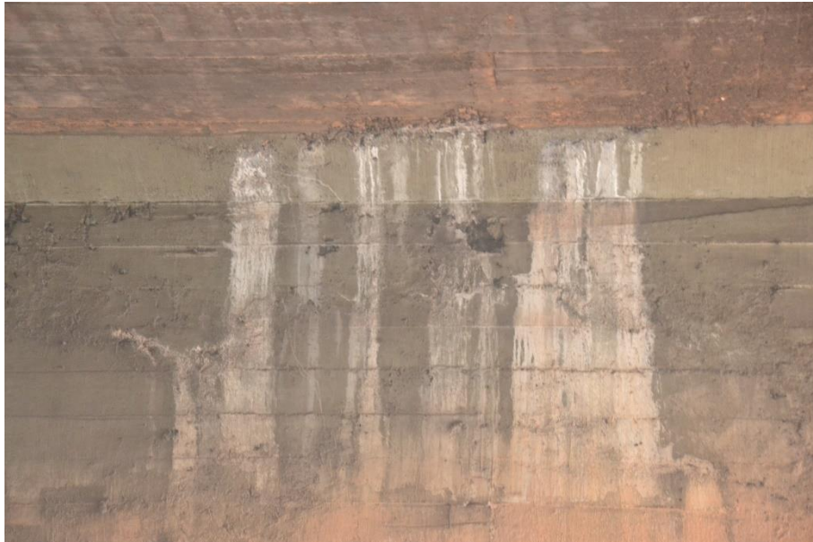
Figura 3.18: Infiltração de água no elemento Tabuleiro – Viaduto W –11/12 Norte.
