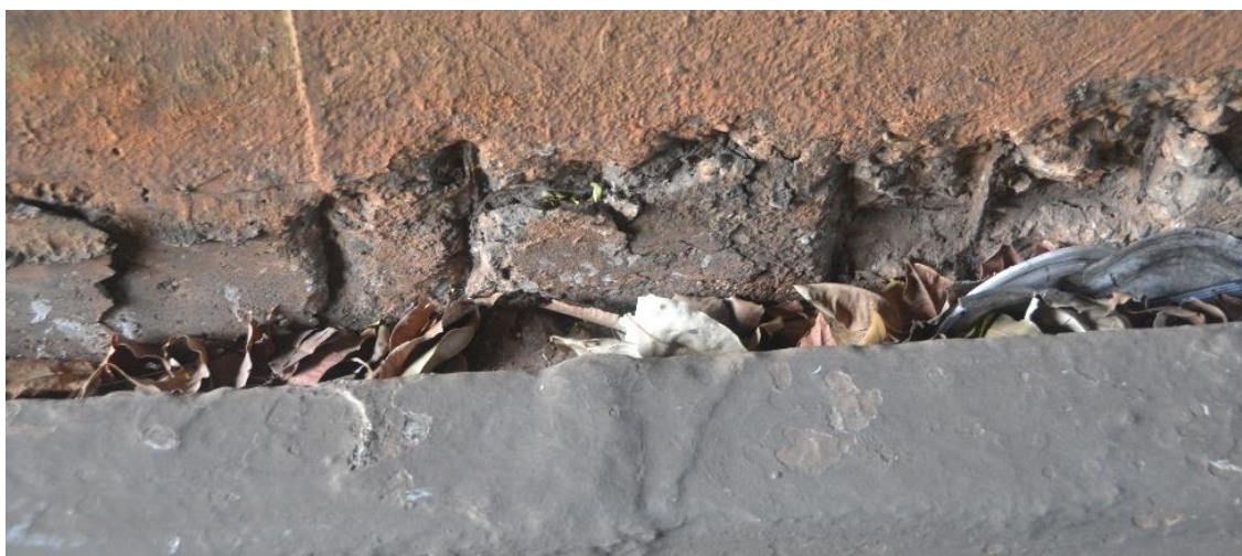
Figura 19: Exemplo C - corrosão das armaduras com fator de intensidade 3
