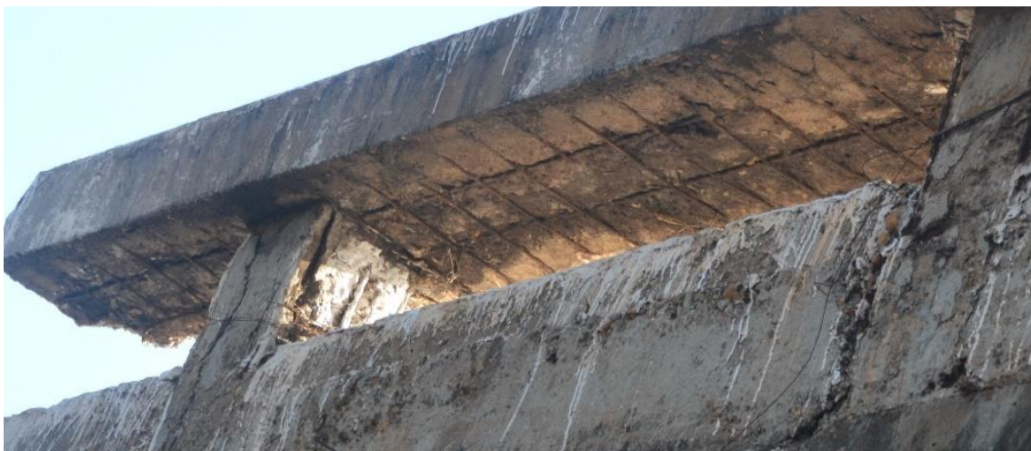
Figura 18: Exemplo B - corrosão das armaduras com fator de intensidade 2
