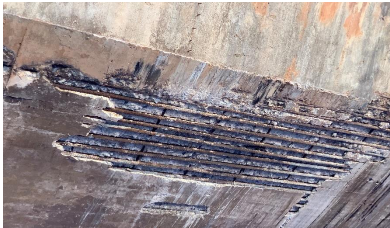
Figura 4.8: Exemplo de abrasão com exposição de armaduras – 11/12 Norte, Brasília – DF
