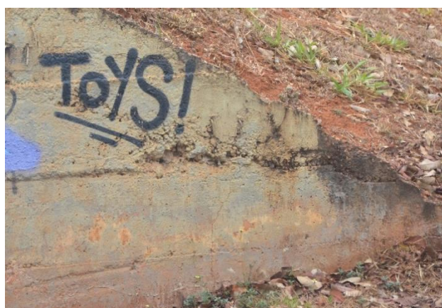
Figura 41: Exemplo A – falha de concretagem com fator de intensidade 1
