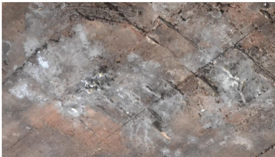
Figura 38: Exemplo B - eflorescência com fator de intensidade 3
