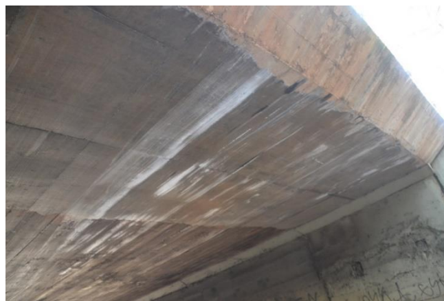
Figura 45: Exemplo A – abrasão do concreto com fator de intensidade 2
