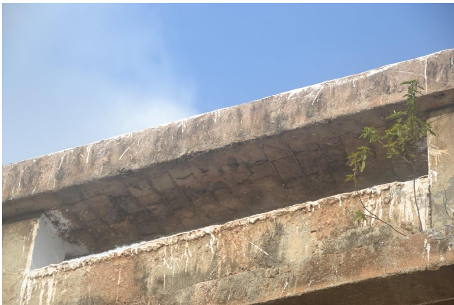
Figura 3.24: Cobrimento deficiente, corrosão e fissuras registradas no elemento Guarda-rodas L – Viaduto W –11/12 Norte.
