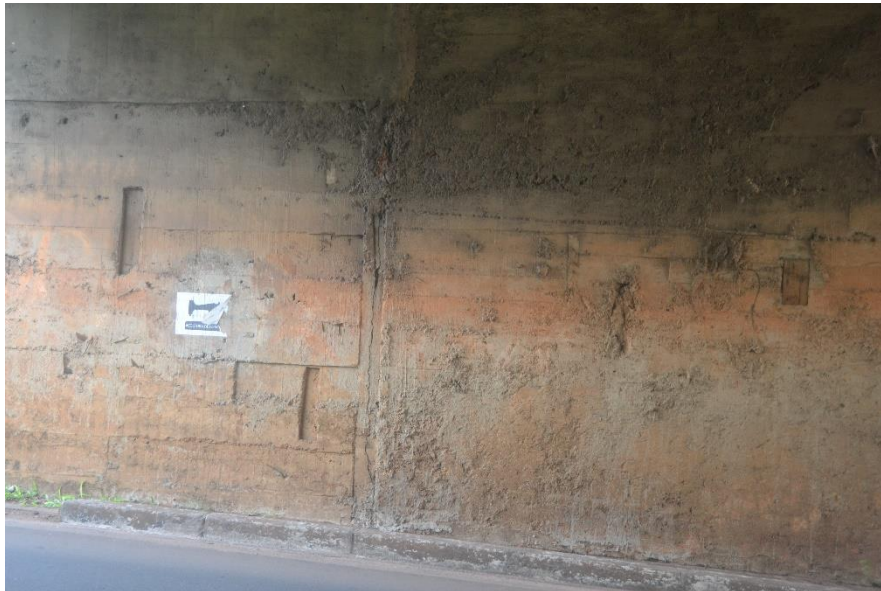
Figura 3.33: Manchas e falhas no elemento Cortina Central Norte – Viaduto W –11/12 Norte.
