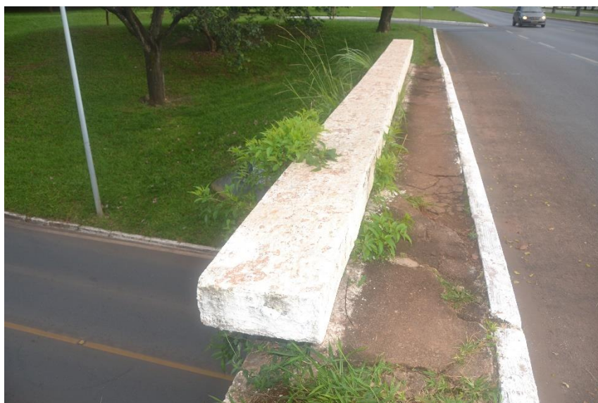
Figura 3.22: Infiltração de água e fissuras registradas no elemento Guarda-rodas W – Viaduto W –11/12 Norte.
