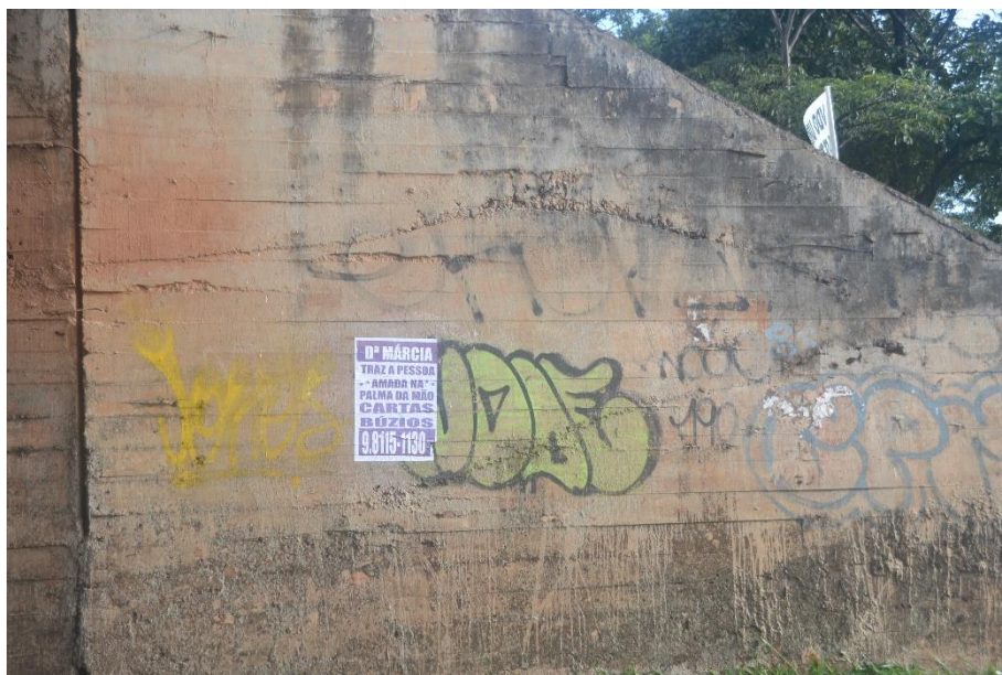
Figura 3.37: Cobrimento deficiente, manchas, falhas de concretagem - Cortina Norte L – Viaduto W –11/12 Norte.
