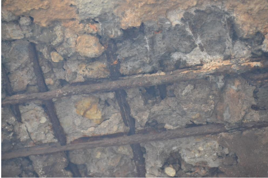
Figura 20: Exemplo A - corrosão das armaduras com fator de intensidade 4
