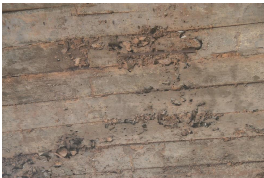
Figura 3.17: Desagregação - Tabuleiro – Viaduto W –11/12 Norte.
