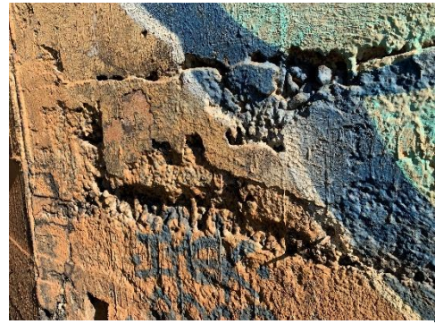
Figura 3.12: Detalhe de dano no Viaduto W - 07/08 Norte
