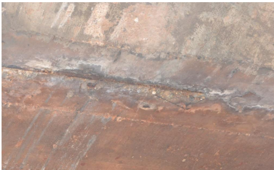
Figura 34: Exemplo B - eflorescência com fator de intensidade 1
