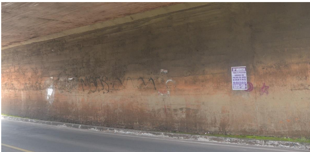
Figura 3.30: Manchas no elemento Cortina Central Sul – Viaduto W –11/12 Norte.
