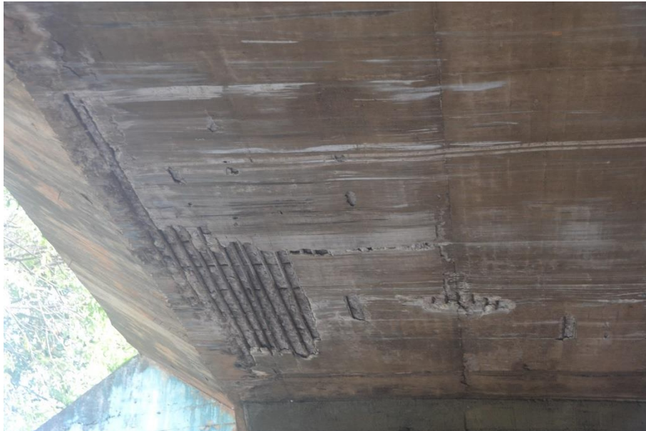
Figura 3.20: Abrasão do concreto no elemento Tabuleiro – Viaduto W –11/12 Norte.
