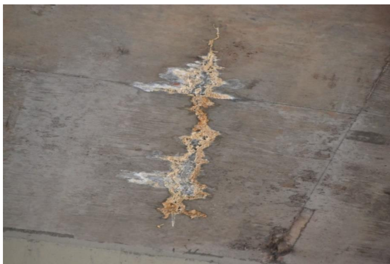
Figura 39: Exemplo A - eflorescência com fator de intensidade 4
