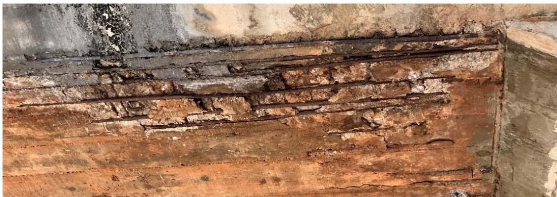
Figura 4.7: Exemplo de corrosão das armaduras – 11/12 Norte – Brasília, DF
