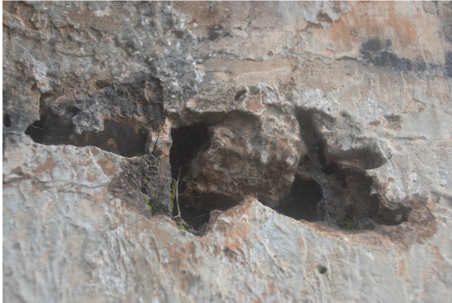
Figura 3.38: Corrosão de armaduras – Cortina Norte L – Viaduto W –11/12 Norte.
