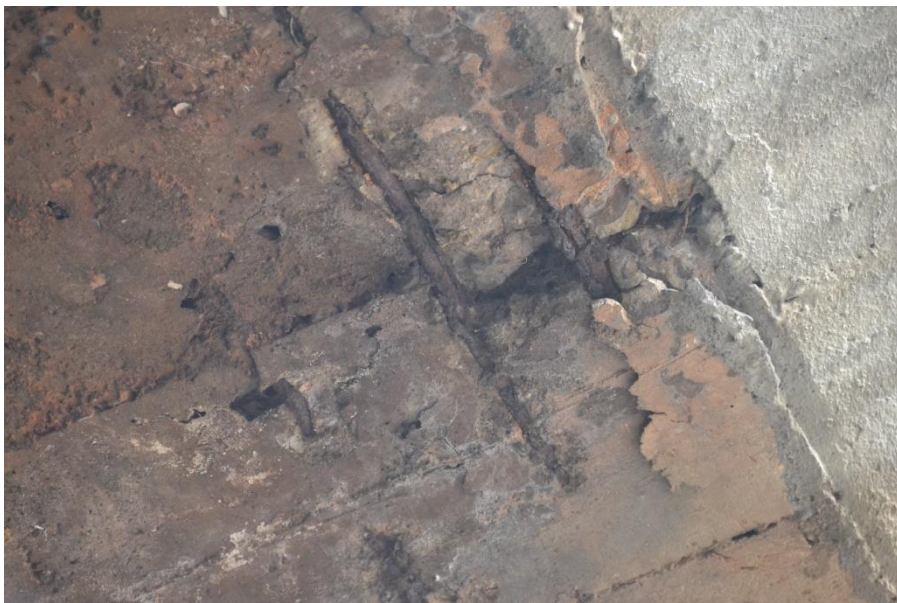
Figura 21: Exemplo B - corrosão das armaduras com fator de intensidade 4
