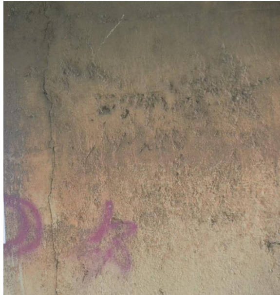
Figura 3.32: Fissuras e falhas de concretagem no elemento Cortina Central Sul – Viaduto W – 11/12 Norte.
