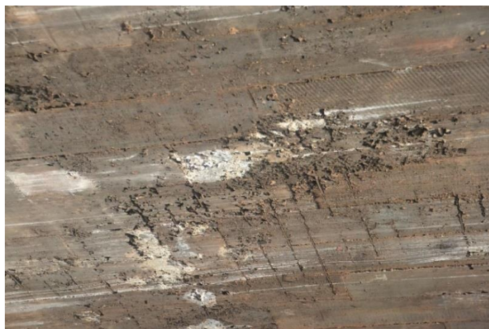
Figura 43: Exemplo A – falha de concretagem com fator de intensidade 3
