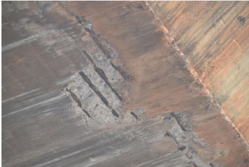
Figura 50: Exemplo C – abrasão do concreto com fator de intensidade 4
