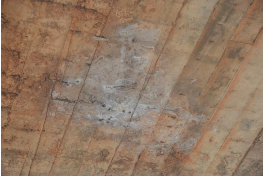
Figura 36: Exemplo B - eflorescência com fator de intensidade 2
