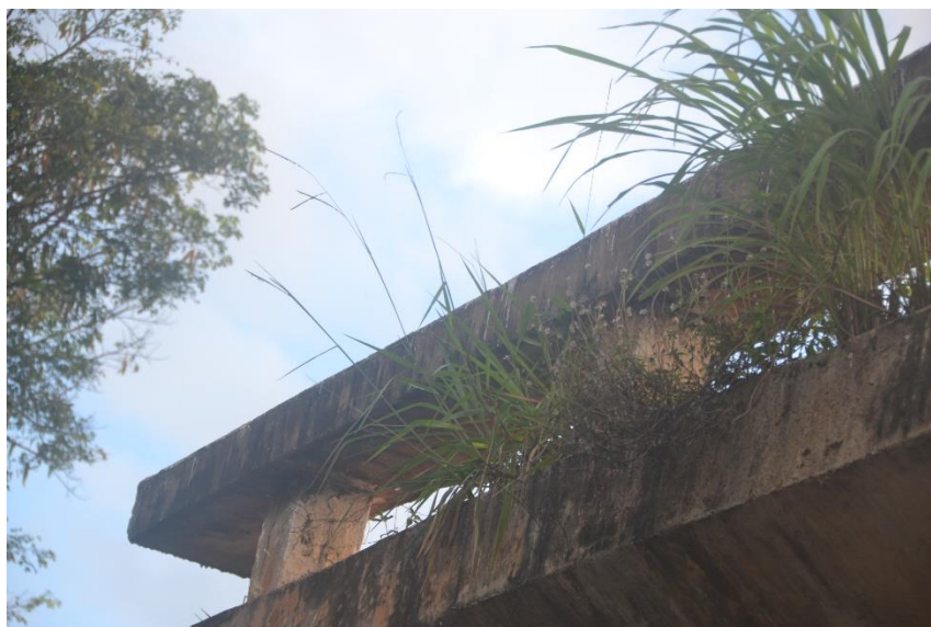
Figura 3.21: Manchas, cobertura deficiente e corrosão registrados no elemento Guarda-rodas W – Viaduto W –11/12 Norte.
