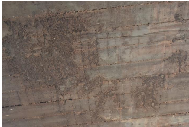
Figura 42: Exemplo A – falha de concretagem com fator de intensidade 2
