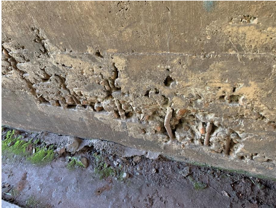
Figura 4.2: Exemplo de falha de concretagem– 05/06 Norte – Brasília, DF
