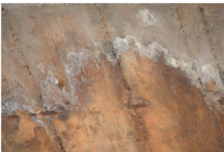
Figura 33: Exemplo A - eflorescência com fator de intensidade 1
