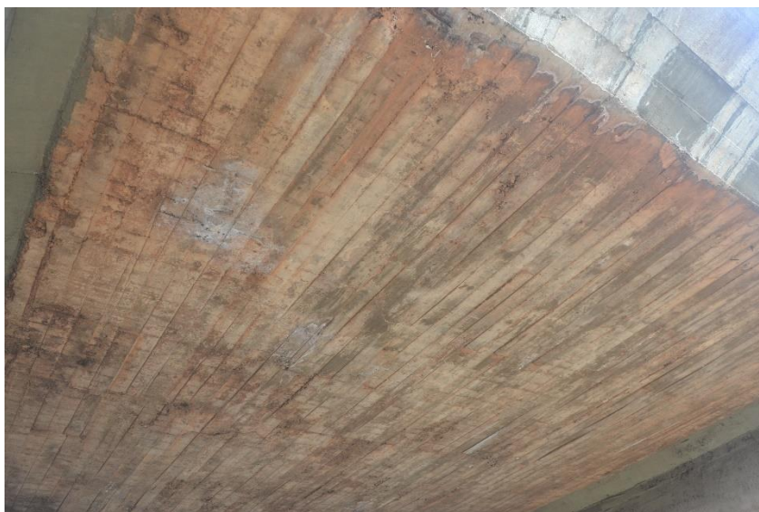
Figura 3.19: Manchas no elemento Tabuleiro – Viaduto W –11/12 Norte.
