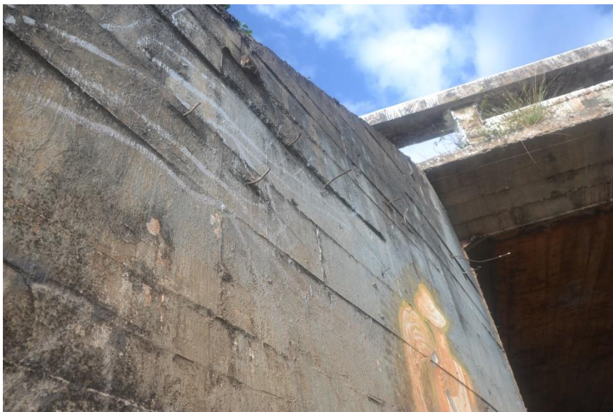
Figura 3.35: Cobrimento deficiente e manchas no elemento Cortina Sul L – Viaduto W – 11/12 Norte.
