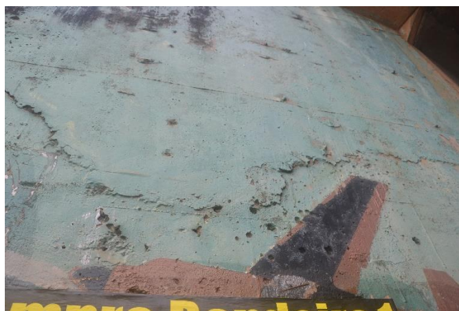
Figura 3.29: Falha de concretagem – Cortina Norte W – Viaduto W – 11/12 Norte.
