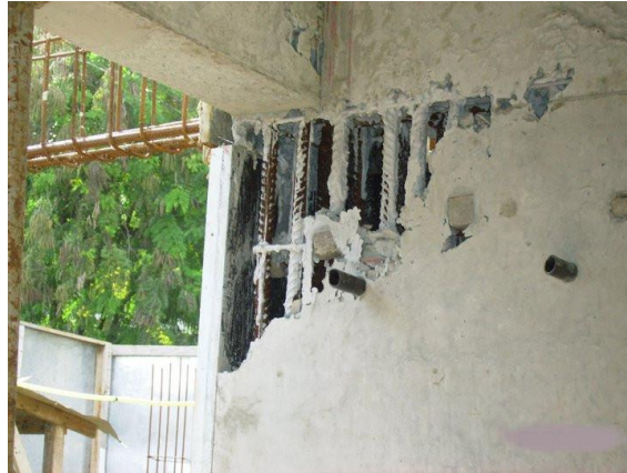
Figura 44: Exemplo A – falha de concretagem com fator de intensidade 4 (Fonte: www.ecivilengenharia.com )
