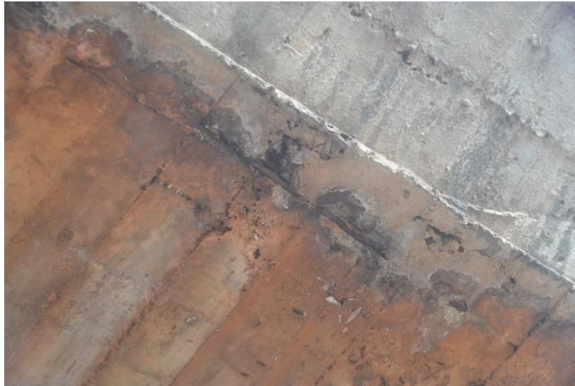
Figura 3.14: Corrosão de armadura no elemento Tabuleiro – Viaduto W –11/12 Norte.
