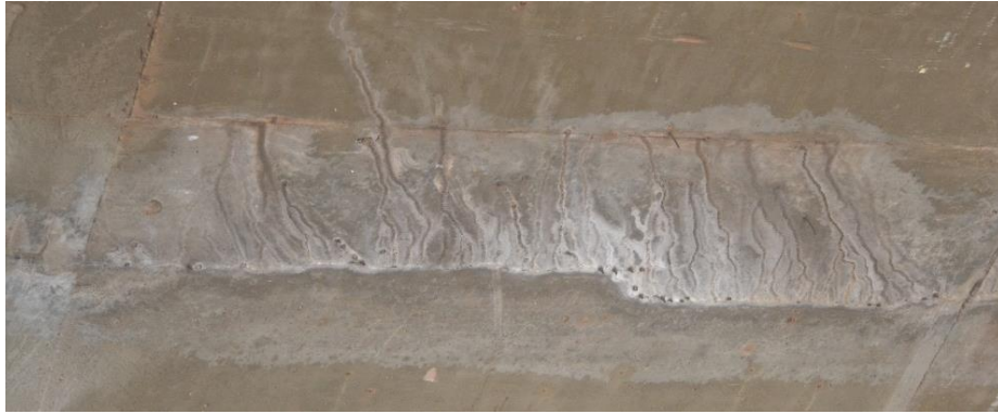
Figura 4.6: Exemplo de Eflorescência – 13/14 Norte – Brasília, DF
