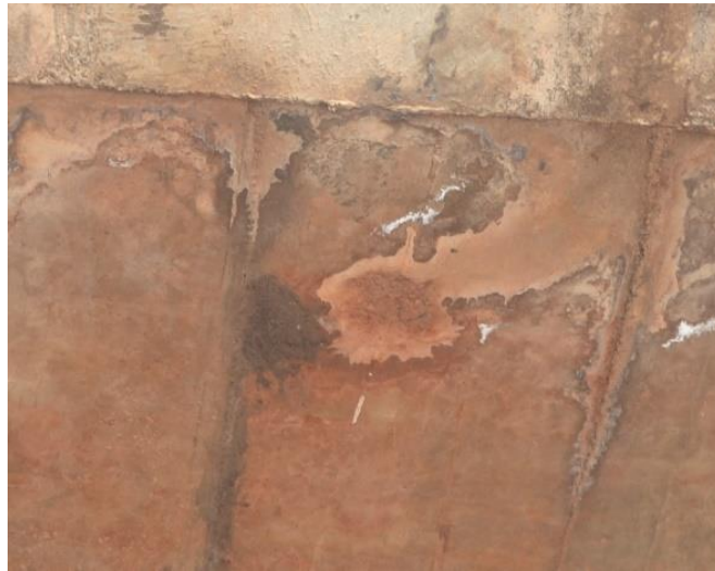
Figura 14: Exemplo A - corrosão das armaduras com fator de intensidade 2
