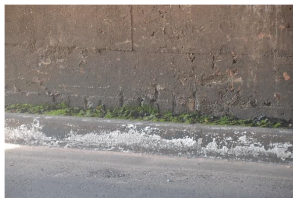
Figura 3.31: Cobrimento deficiente, corrosão e desagregação no elemento Cortina Central Sul – Viaduto W –11/12 Norte.
