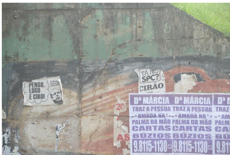
Figura 3.27: Fissuras no elemento Cortina Sul W – Viaduto W –11/12 Norte.
