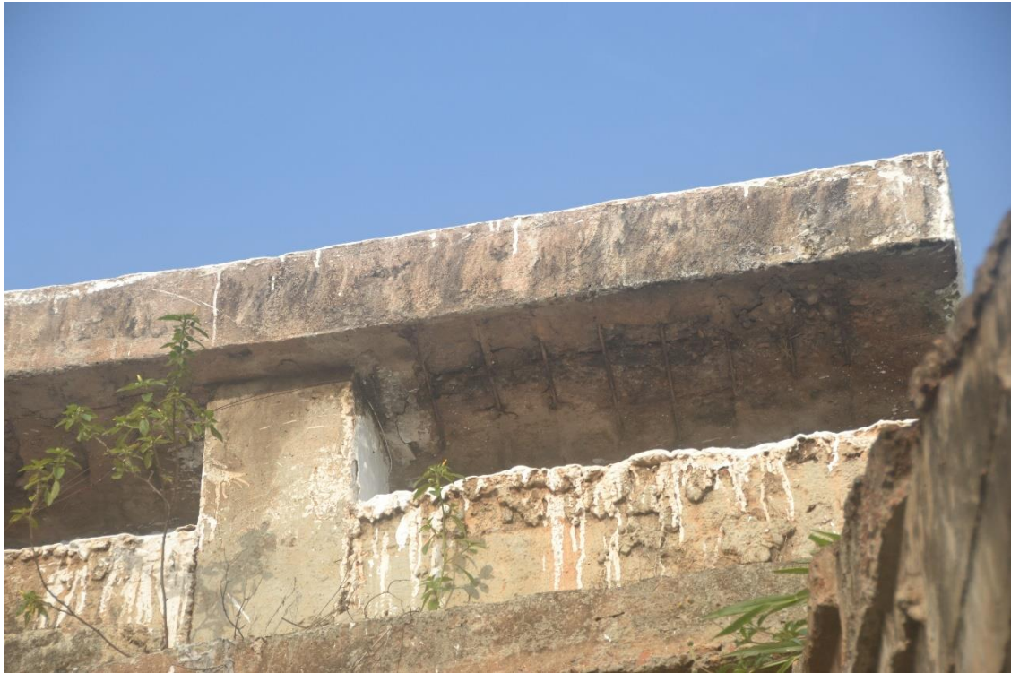
Figura 3.25: Desagregação e eflorescência registrada no elemento Guarda-rodas L – Viaduto W –11/12 Norte.
