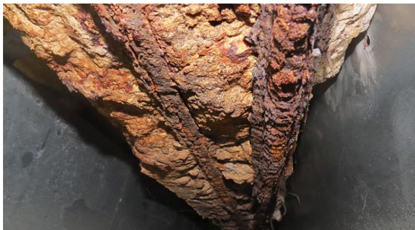
Figura 22: Exemplo C - corrosão das armaduras com fator de intensidade 4 (Fonte: www.axfiber.com.br )
