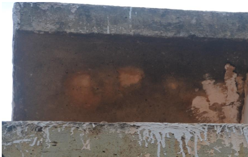
Figura 16: Exemplo C - corrosão das armaduras com fator de intensidade 2
