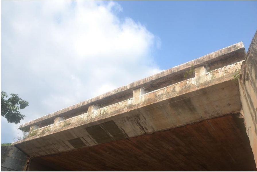
Figura 3.23: Manchas e infiltração de água registradas no elemento Guarda-rodas L – Viaduto W –11/12 Norte.
