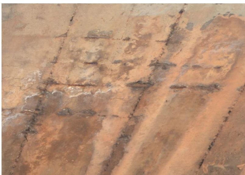
Figura 17: Exemplo A - corrosão das armaduras com fator de intensidade 3
