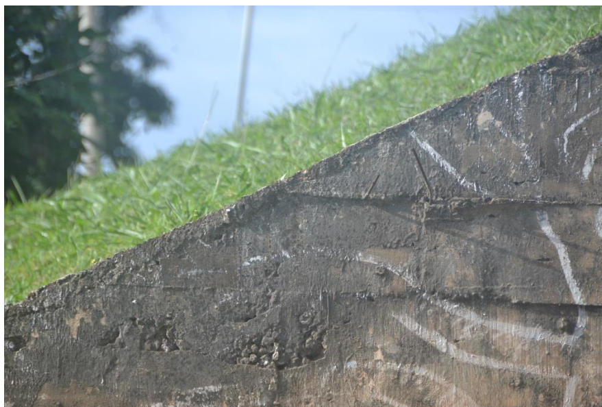
Figura 3.36: Falhas de concretagem/desagregação - Cortina Sul L – Viaduto W –11/12 N.
