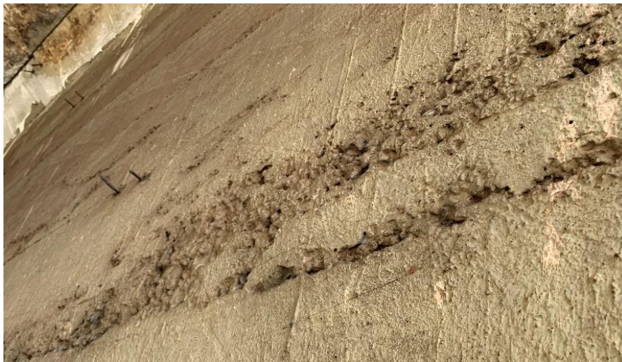
Figura 4.3: Exemplo de falhas de concretagem – 01/02 Norte, Brasília – DF
