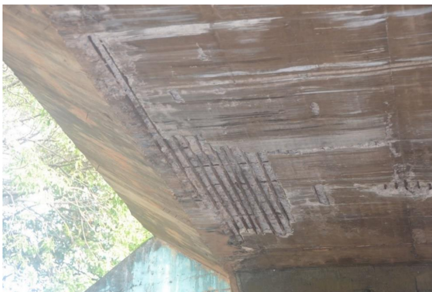
Figura 48: Exemplo A – abrasão do concreto com fator de intensidade 4
