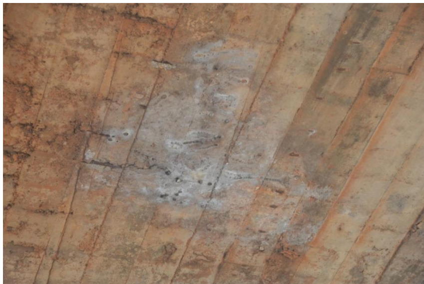
Figura 3.16: Eflorescência no elemento Tabuleiro – Viaduto W –11/12 Norte.
