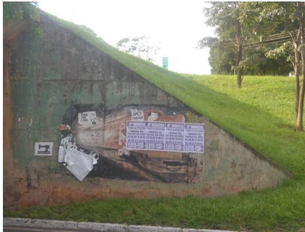
Figura 3.26: Manchas no elemento Cortina Sul W – Viaduto W –11/12 Norte.
