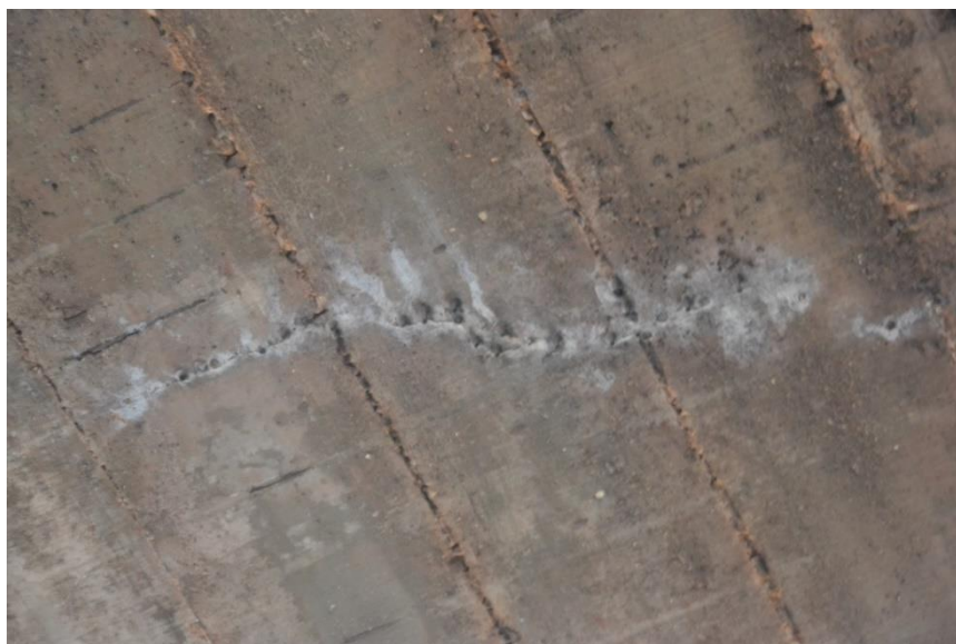
Figura 35: Exemplo A - eflorescência com fator de intensidade 2
