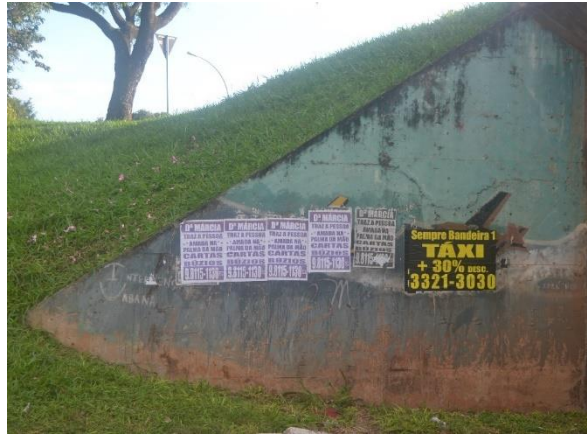
Figura 3.28: Manchas no elemento Cortina Norte W – Viaduto W – 11/12 Norte.
