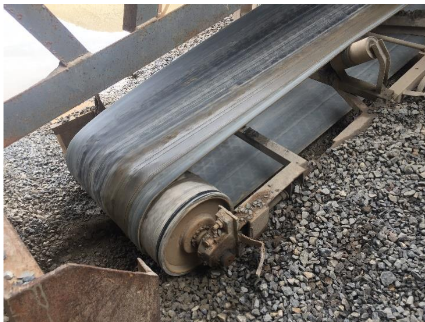
Figura 3.12 Acúmulo de material entre tambor e correia (Arquivo Pessoal)
