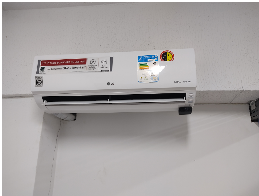
Figura 4.24. Ar condicionado utilizado para os testes realizados no projeto com a caixinha colada no canto direito inferior. Fonte: Elaborada pelo autor.
