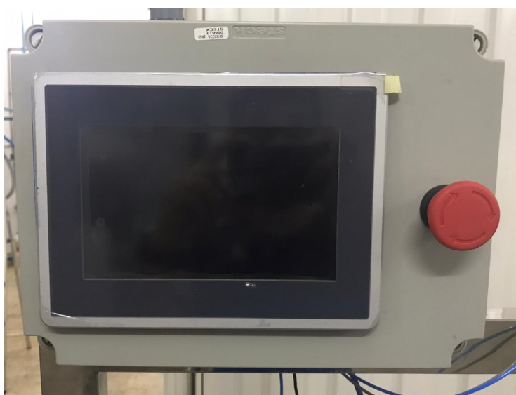
Figura 4.27: Controlador p300 instalado no maquinário e botão de emergência geral.
