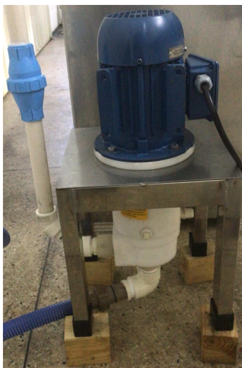
Figura 4.1: Nova bomba pressurizadora da unidade de envase
