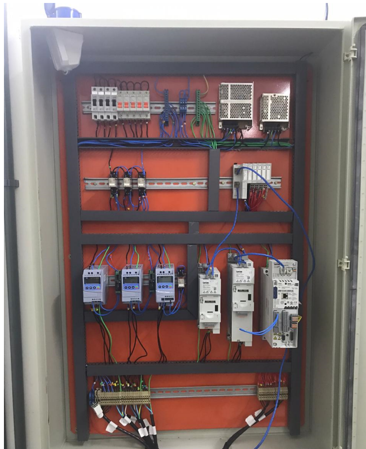
Figura 4.28: Quadro de automação implementado.
