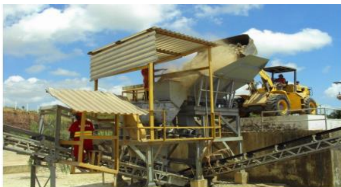
Figura 27: Britador de RCD na USIBEN/JP
