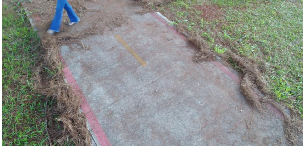
Figura 38– Sujeira no pavimento. Fonte: Autor, 2020.
