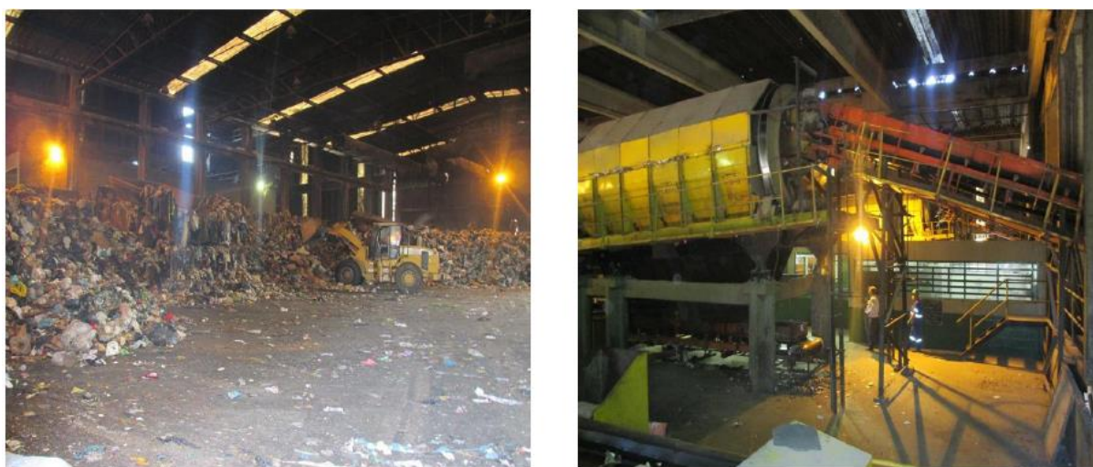
Figura 6-1: Local de entrada dos resíduos e alimentação da peneira rotativa primária
