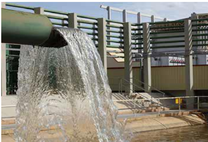
Figura 14 - Estação de tratamento de efluentes.
