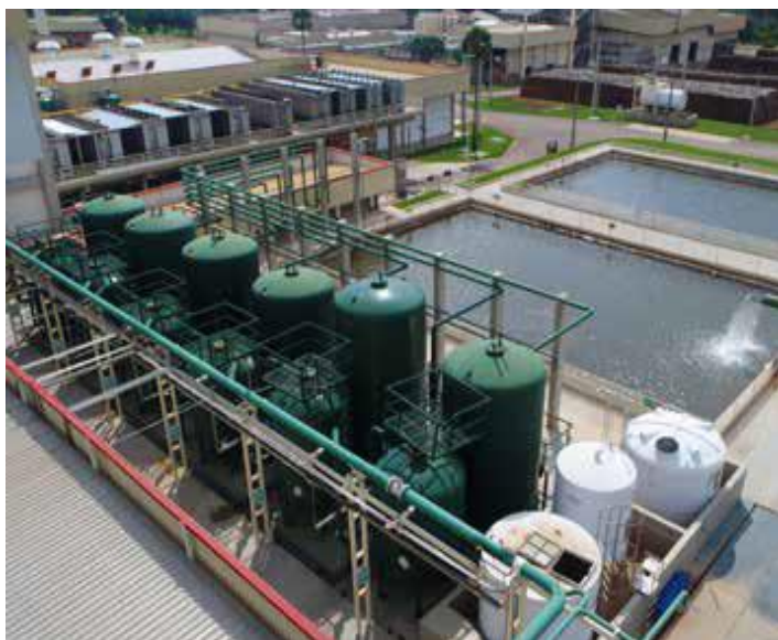
Figura 15 - Estação de tratamento de efluentes 2.
