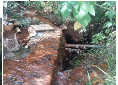
Fotografia 12 - Erosão a jusante do ponto de coleta CRe1
