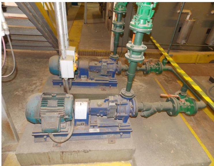
Figura 3-15 - Bomba de água fria PU-9018 e PU-9020.
