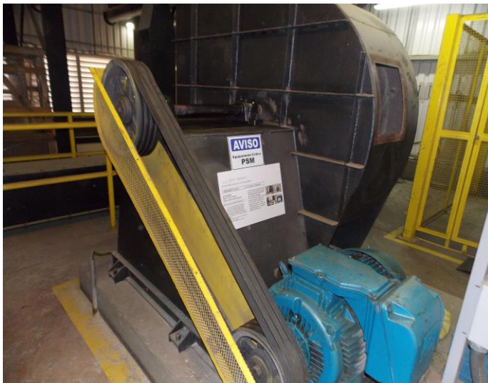
Figura 3-13 - Ventilador boiler BL-9040 e BL-9035.
