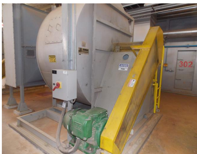
Figura 3-6 - Ventilador principal da linha 300.
