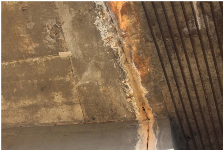
Figura 4.11 - Elemento Tabuleiro – Eflorescência
