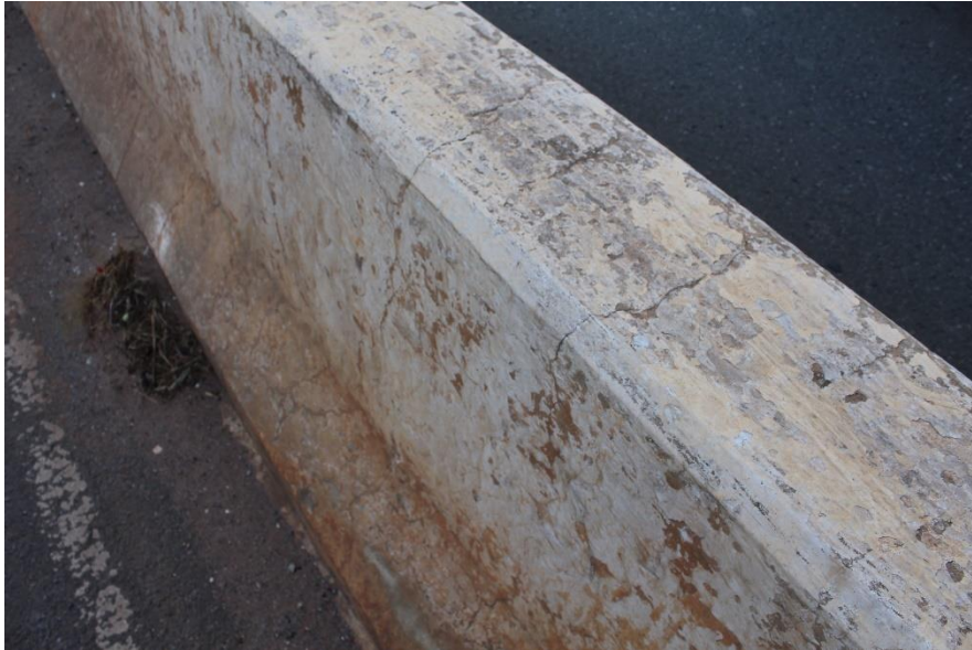
Figura 4.8 - Elemento Guarda Rodas Norte – Fissuras
