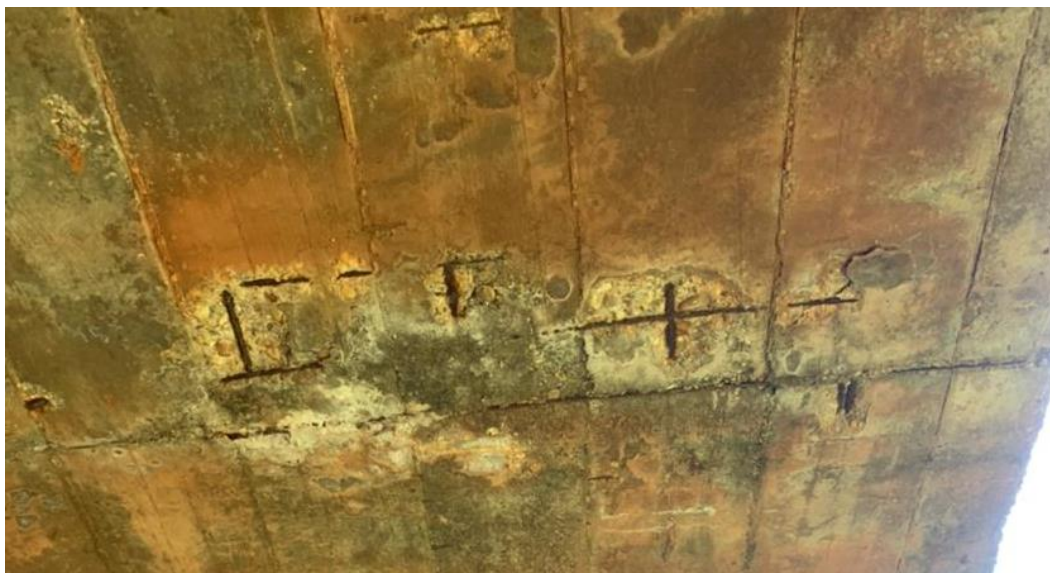
Figura 2.3 - Exemplo de desagregação - Viaduto sobre Ferrovia na BR-251
