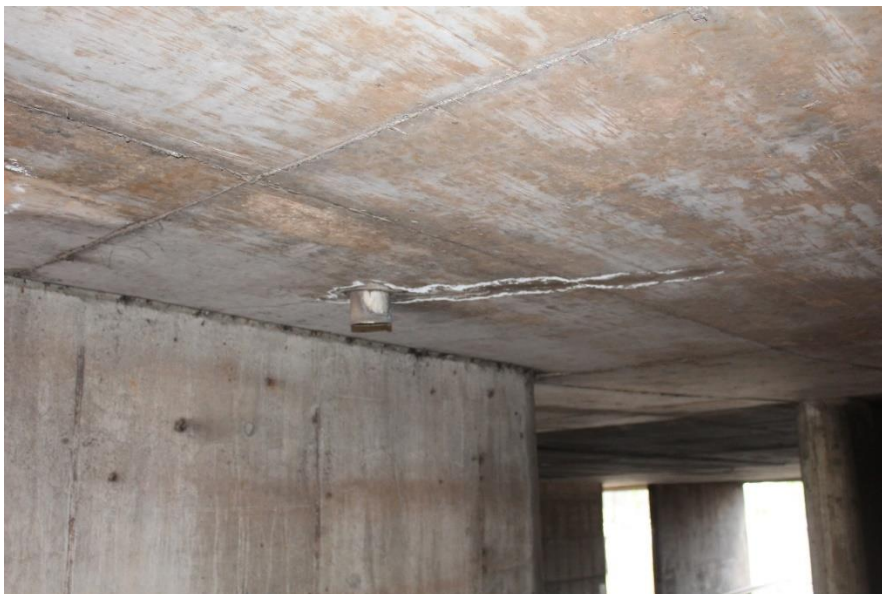
Figura 4.9 - Tabuleiro Leste - Eflorescência
