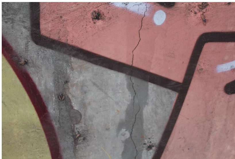
Figura 2.4 - Exemplo de fissura - Viaduto 2 sobre a DF-003 acesso ao Guará.
