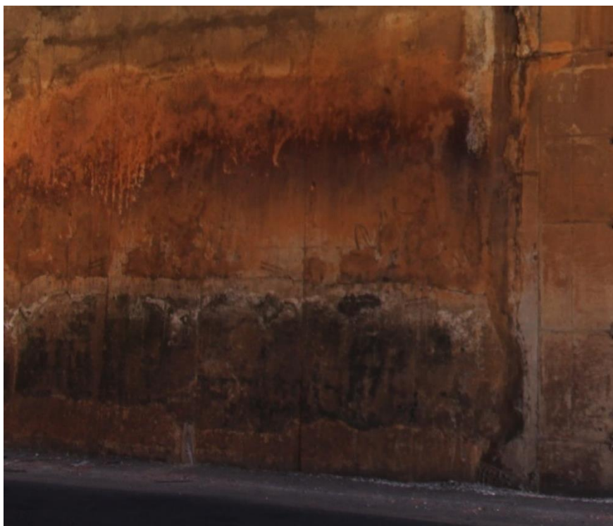
Figura 2.1 - Exemplo de manchas na superfície do concreto – Viaduto 4 na DF-003 acesso ao Aeroporto JK.
