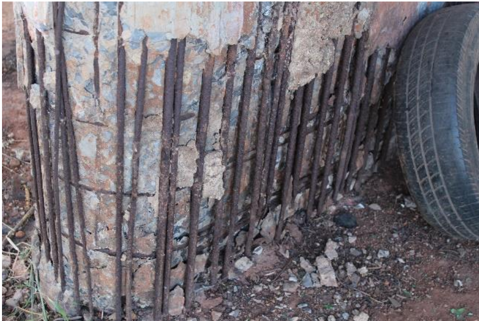
Figura 4.4 - Elemento Pilar 4 com corrosão de armadura e deslocamento
