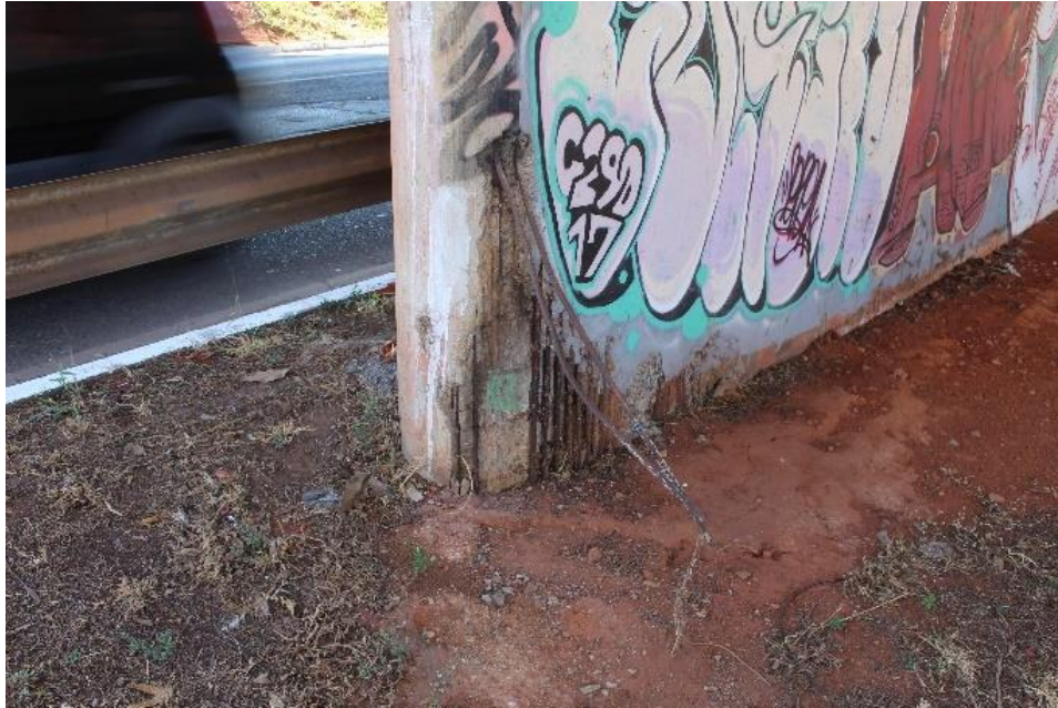
Figura 4.5 - Elemento Pilar 5 com corrosão de armadura e deslocamento
