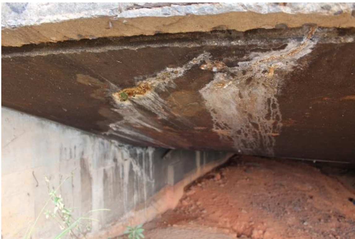
Figura 2.5 - Exemplo de efluorescência - Viaduto 3 sobre a DF-003 acesso ao Guará.
