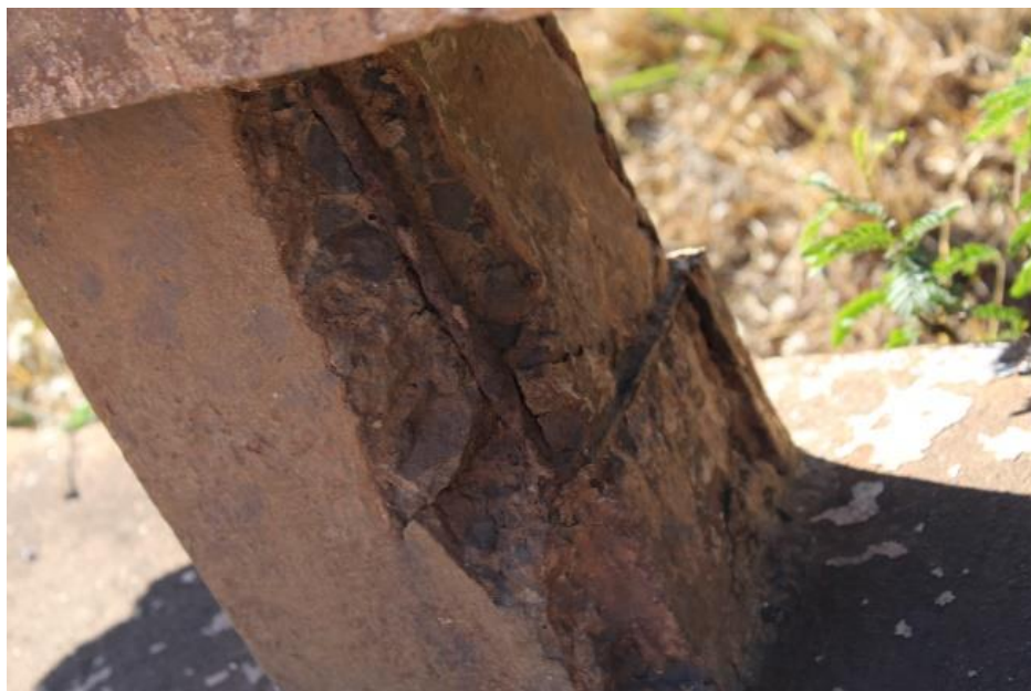
Figura 4.6 - Elemento Guarda Rodas Norte – Corrosão de armadura
