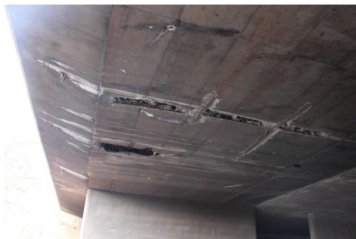
Figura 2.7 - Exemplo de abrasão do concreto com exposição de armaduras - Viaduto 3 sobre a DF-003 acesso ao Guará
