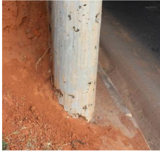
Figura 2.2 - Exemplo de falha de concretagem - Viaduto 3 sobre a DF-003 acesso ao Guará
