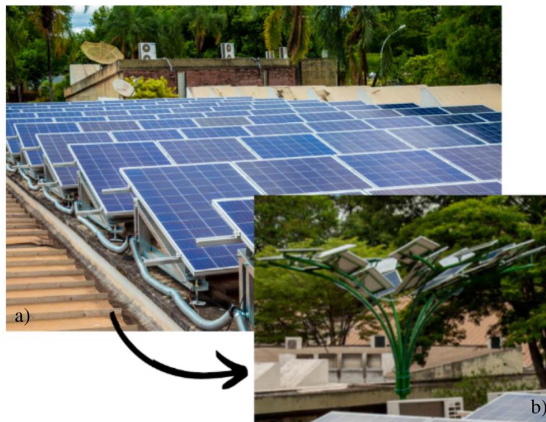
Figura 16. a) Painéis solares no telhado da Faculdade de Tecnologia da Universidade de Brasília; b) Árvore feita de painéis solares na Faculdade de Tecnologia da Universidade de Brasília
