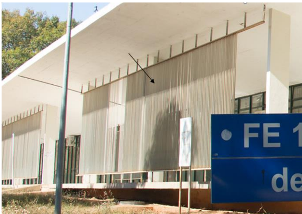
Figura 9. Brise-soleils na Faculdade de Educação 1 (FE1) no campus Darcy Ribeiro da Universidade de Brasília
