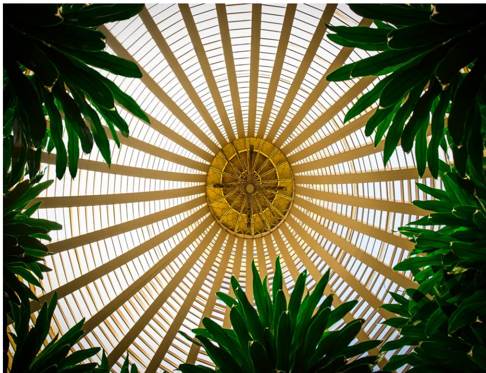
Figura 14. Imagem interna do dispositivo shed no telhado do Memorial Darcy Ribeiro da Universidade de Brasília
