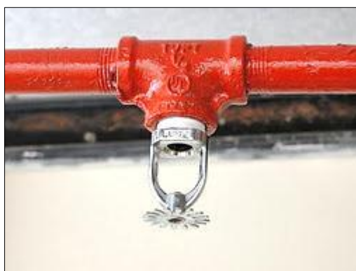
Figura 2.2 – Detalhe de uma tubulação com sprinkler (Central Gás, 2011)
