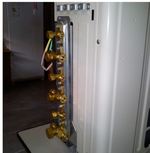
Figura 3.18 – Conexões da rede frigorígena da condensadora.
