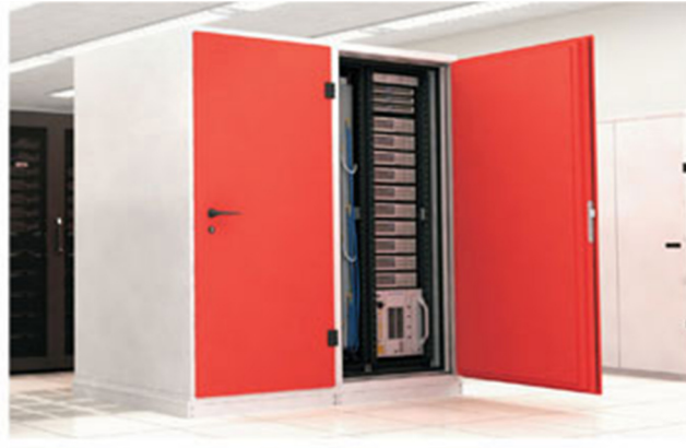
Figura 1.4 - Climatização de precisão - exemplo de instalação, (ACECO TI, 2010).
