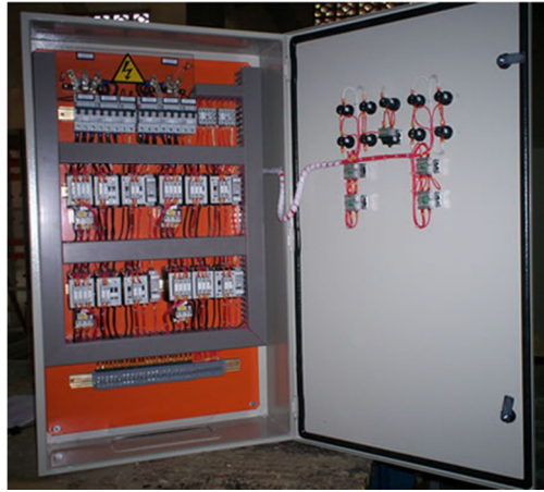
Figura 3.15 - Quadro elétrico típico (MONTPAINEIS, 2011).
