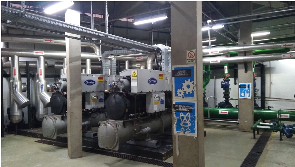
Figura 3.4: Central de água gelada do edifício, com destaque para os CH-01 e CH-02
