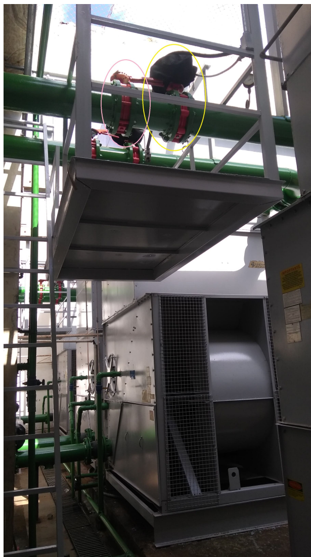
Figura 3.17: Válvulas de entrada de água na torre, sendo a válvula motorizada (coberta por pano de proteção) circulado em amarelo e a válvula manual circulado em rosa
