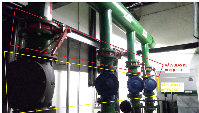
Figura 3.13: Válvulas de bloqueio tipo borboleta das bombas de água de condensação parcialmente fechadas
