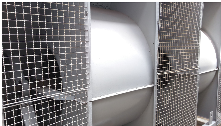
Figura 3.7: Tomada de ar dos ventiladores centrífugos das torres de resfriamento
