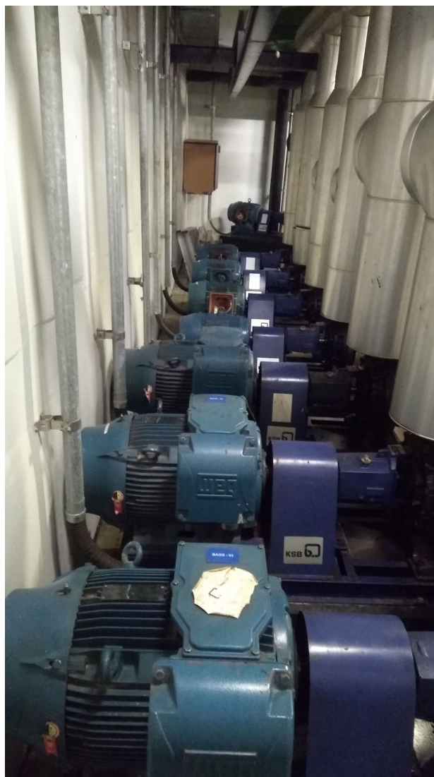
Figura 3.14: Conjunto de bombas secundárias (à frente) e conjunto de bombas (ao fundo). Também é possível ver uma das bombas de água de condensação bem ao fundo, em ângulo com o barrilete primário.
