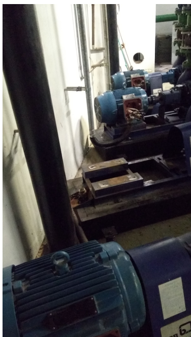
Figura 3.12: Conjunto de bombas de água de condensação, com uma bomba ausente para reparos
