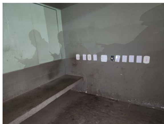
d. tomadas sem energia no ponto de apoio
