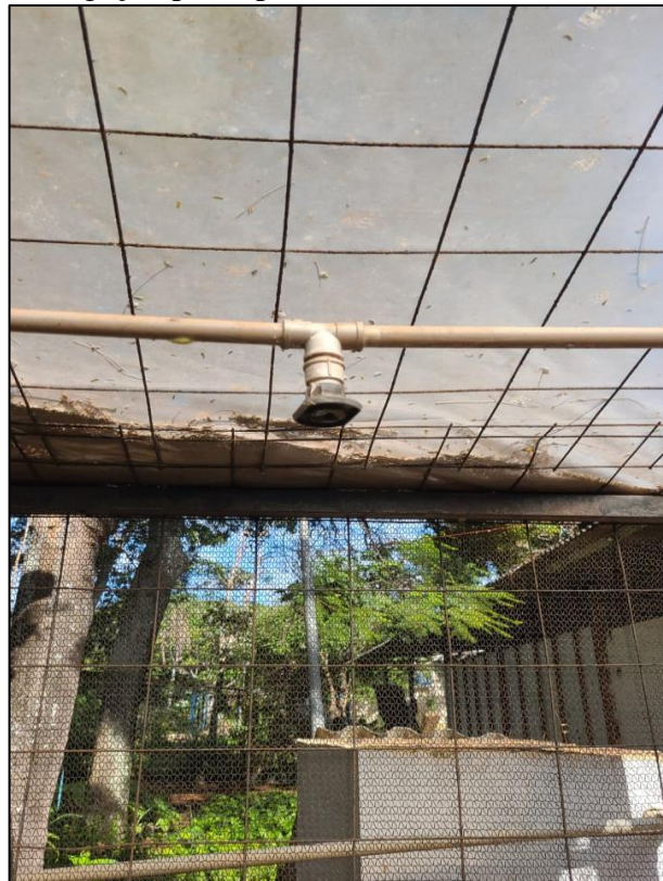
Figura 28: Irrigação por aspersão com acionamento automatizado.
