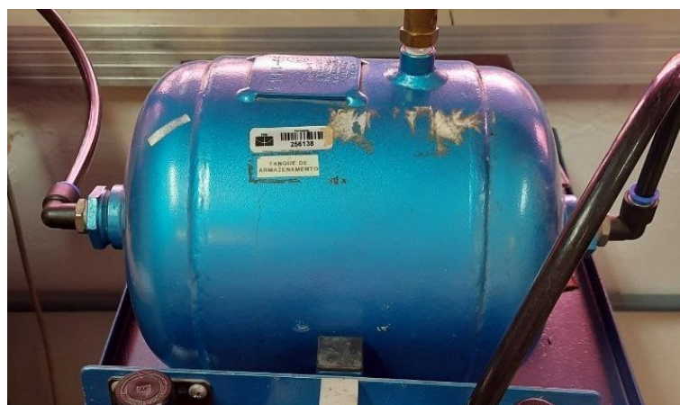
Figura 29 – Tanque de armazenamento de ar
