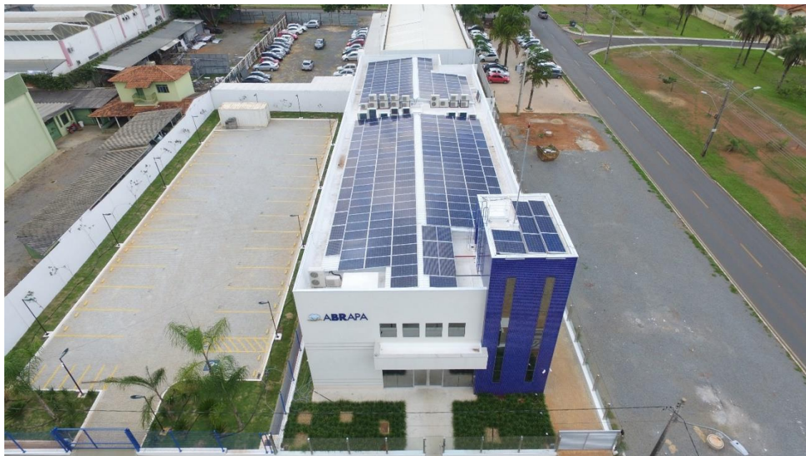
Figura 4.1 - Sistema solar fotovoltaico do 1º caso com instalação sobre telhado em Brasília-DF
