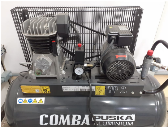
Figura 16 – Foto do Compressor.
