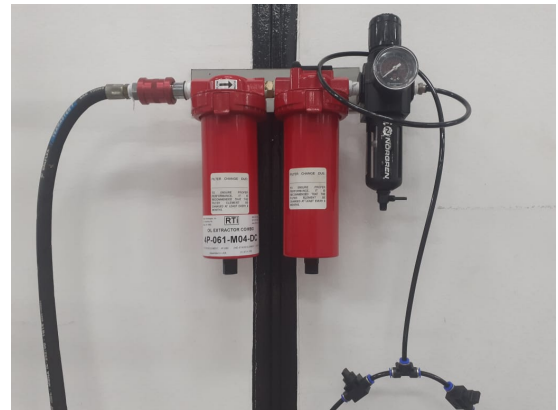
Figura 17 – Foto dos filtros, válvulas de bloqueio e derivador T.
