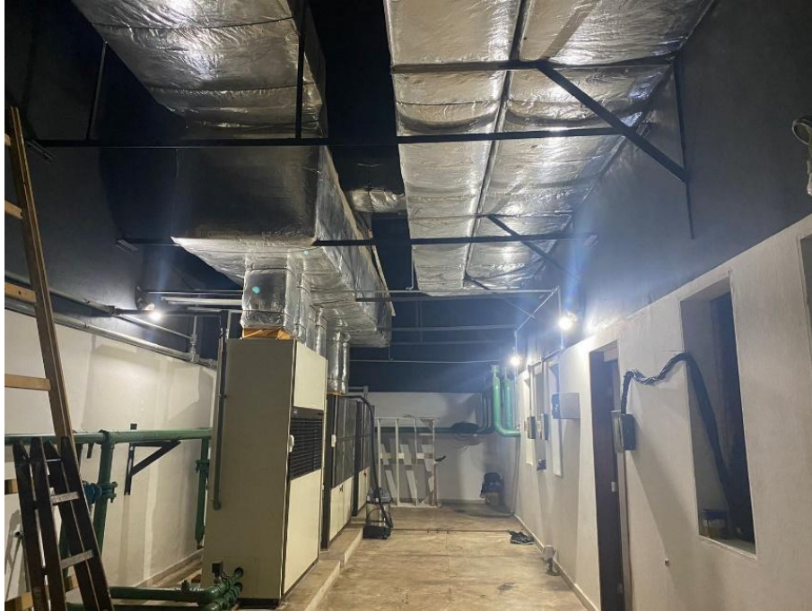
Figura 16: Casa de máquinas com equipamentos de refrigeração e ar-condicionado.
