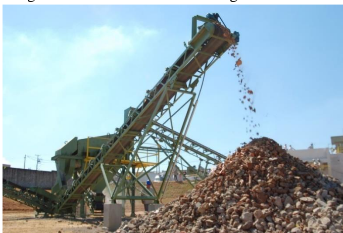
Figura 2.3 – Usina fixa de reciclagem de entulhos
