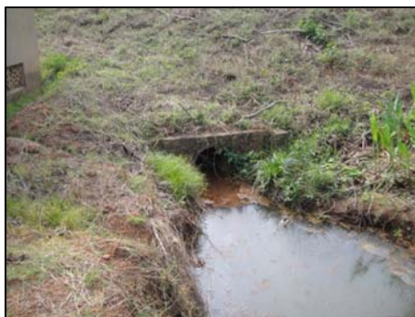
FIGURA 9. Saída da vazão ecológica pelo desarenador.
