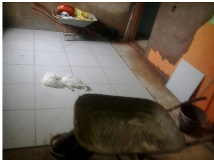
Figura 4 - Ambiente de trabalho de aluno da Educação de Jovens e Adultos – operário da construção civil
